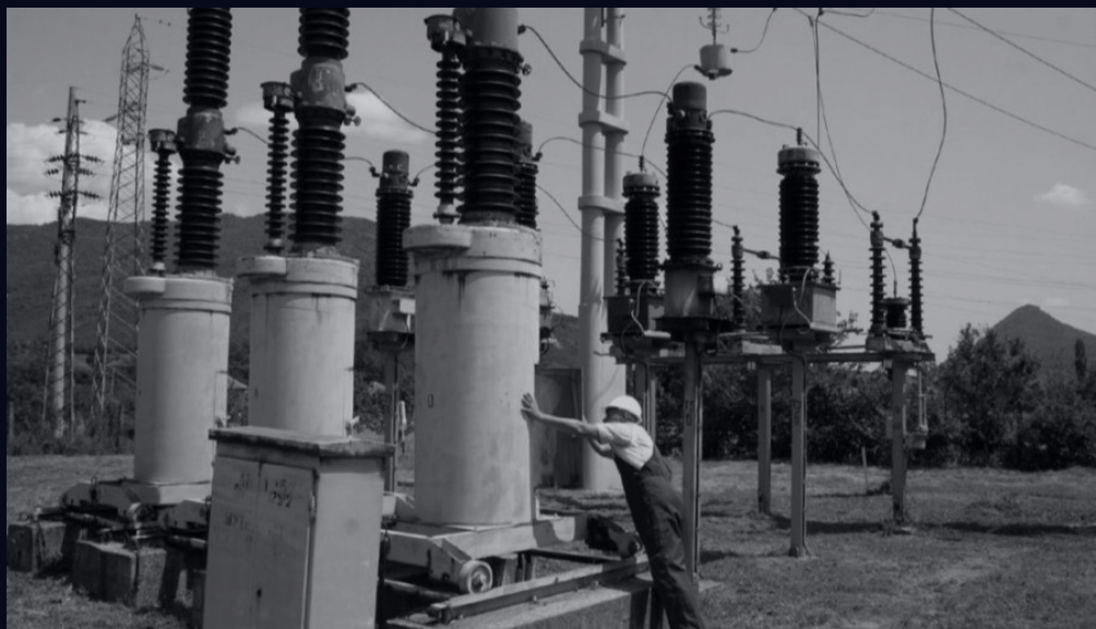
RADNIK NA TRAFOSTANICI VALAČ
